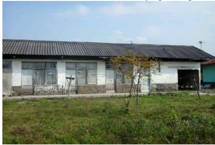
Gambar 1: Kondisi Kantor Stasiun Pirusa yang terbengkalai
